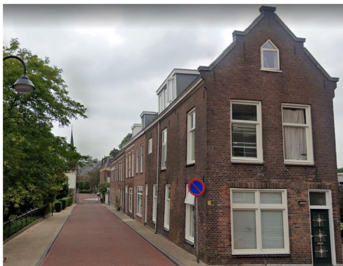
Figuur 11: Scheve voorgevels op de Wal in Schoonhoven, van Google Street View
